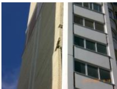
А. Трещины в облицовочной кладке на фасадах
