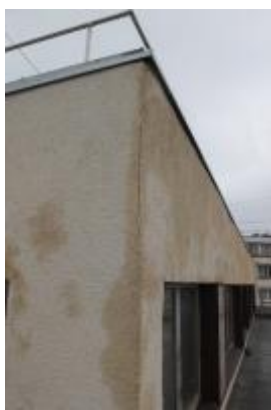
Ж. Повреждения штукатурных поверхностей на фасадах
