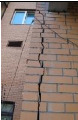
Б. Отслоение кирпичной облицовки
